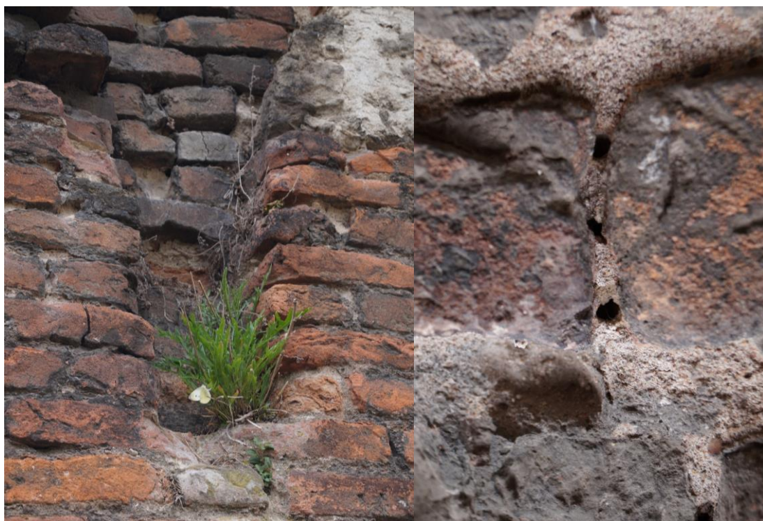
Abbildung 16: Nischen, Vorsprünge und verwittrte Kalkfugen sind bedeutende Habitatstrukturen für mauertypische Pflanzen und Tierarten. (T. Braun)
