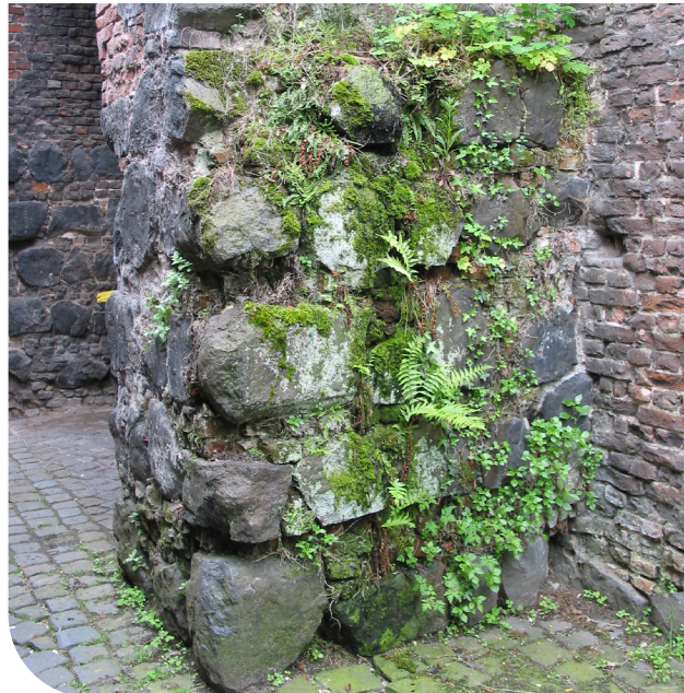
Bewuchs mit Moosen, Mauerfarne, Glas- und Zimbelkraut an der Nordseite eines Wachtürmchens (vor Sanierung der Mauer 2020)
